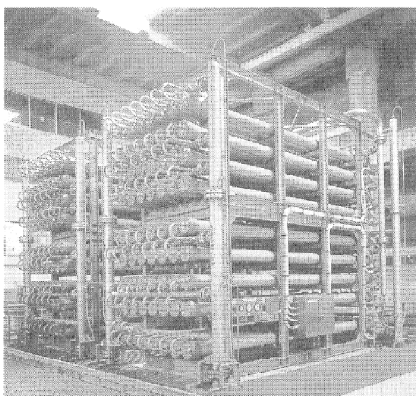
図1 沖縄県北谷浄水場の海水淡水化施設 (造水能力1日1万立方米、東レ(株)資料)
