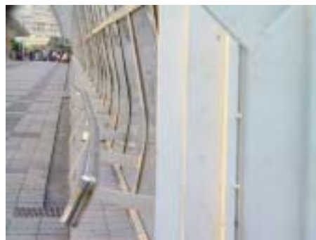
図2 群集の圧力で曲がった手すり （歩道橋東側南端）
