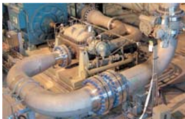
図12．現地試運転中のMSH300/2T
