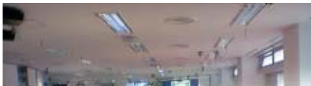
図6．天井に設置されたセンサー類
