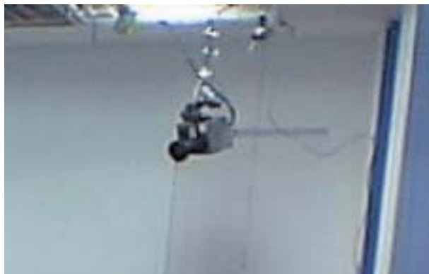
図7．天井に設置されたカメラの拡大図
