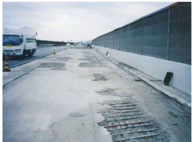
写真-2 アスファルト舗装下の床版上面 コンクリートの劣化状況
