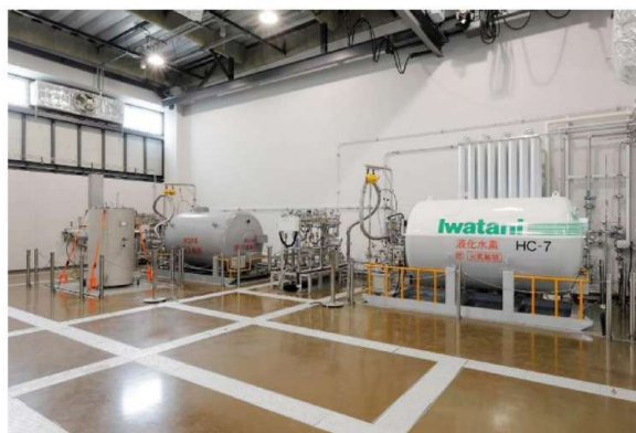
図8 岩谷水素技術研究所の液化水素実験室
