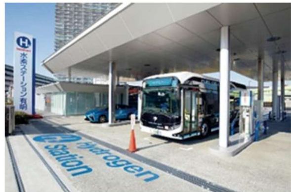
図5 イワタニ水素ステーション有明 6) (液化水素昇圧ポンプを設置)
